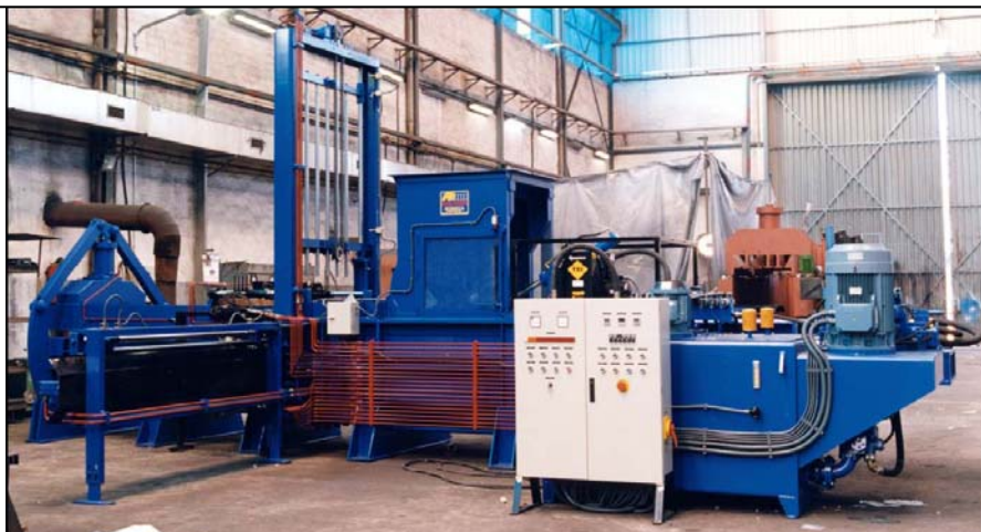
Anpassning efter önskemål som ventilations kåpor och inneslutning av balpressar.
